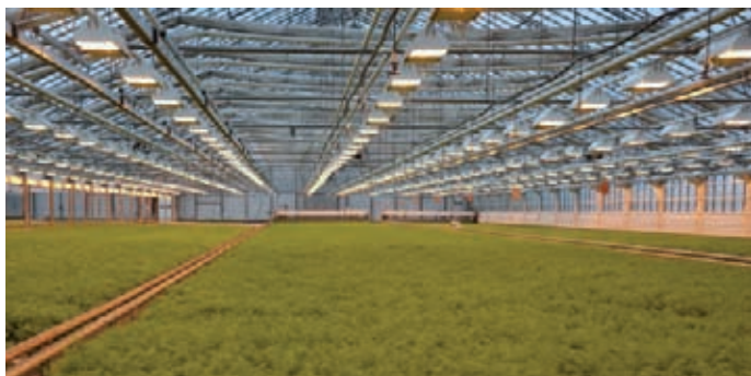
Figur 4.12. Armaturinstallation över hel odling
